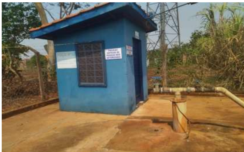
Figura 23- Abrigo e quadro de automação de poços.
