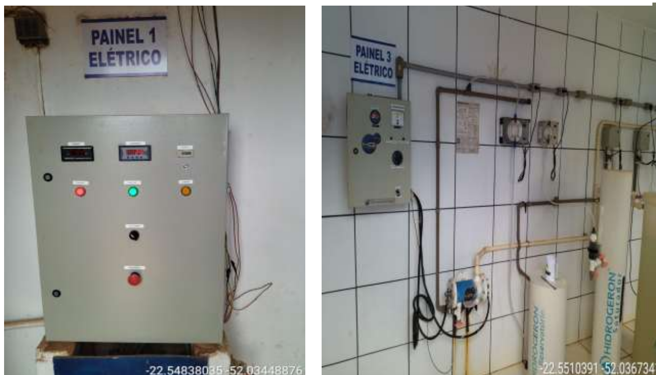
Figura 21 - Quadros de comando da captação subterrânea
