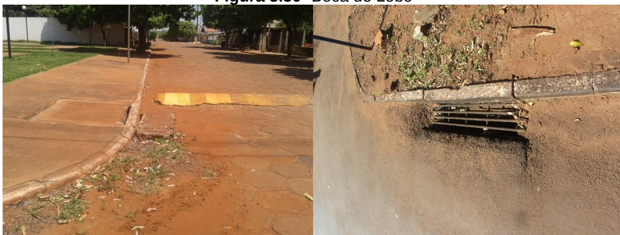
Figura 3.30- Boca de Lobo
