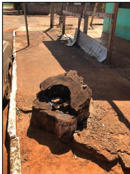
Figura 27. Tronco não retirado.
