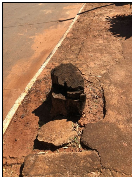
Figura 29. Tronco não retirado.
